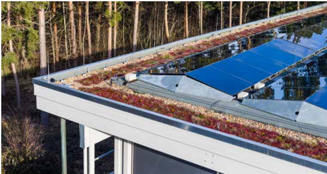
PV-Anlage auf dem Dach der Ausstellungspavillon im LVR-Freilichtmuseum Kommern
